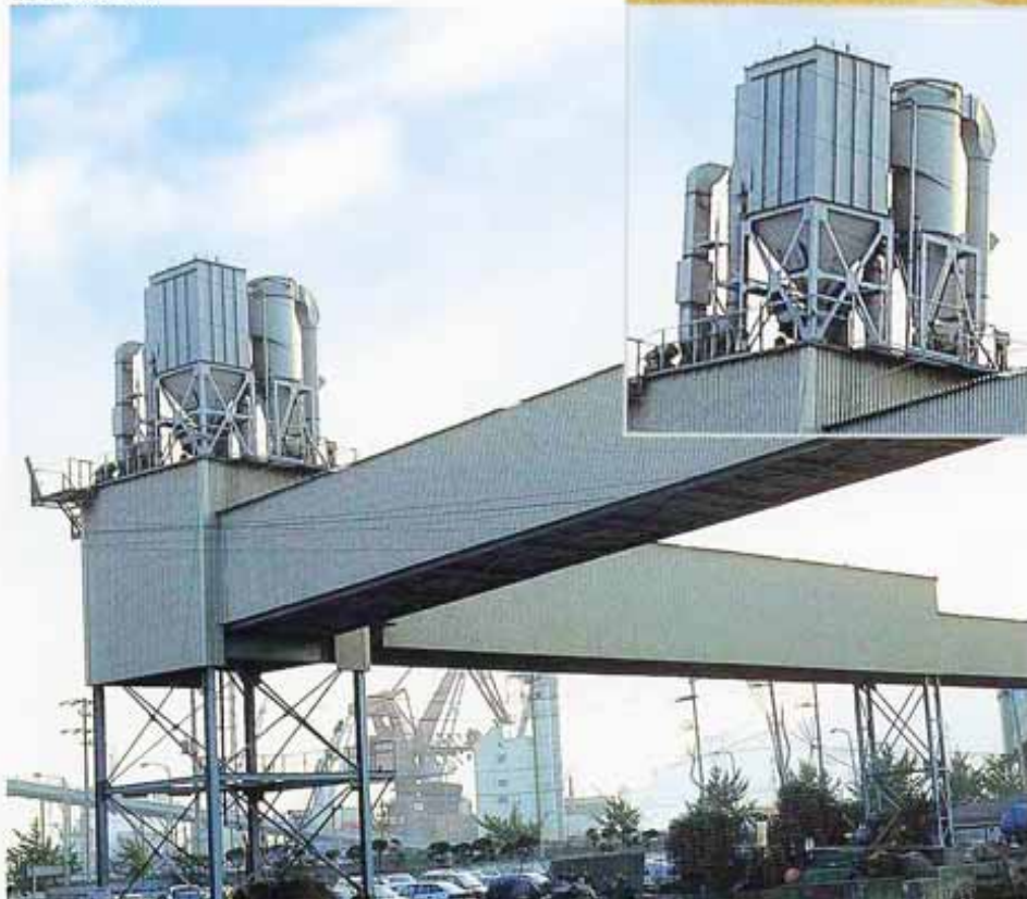
집진기 / Dust Collector
