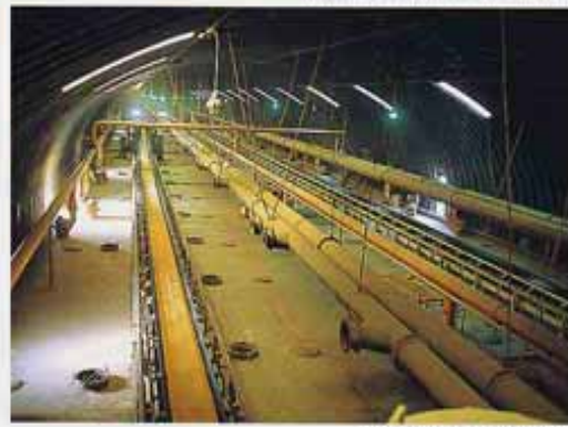
분리입고 콘베이어시설 / Conveyor
